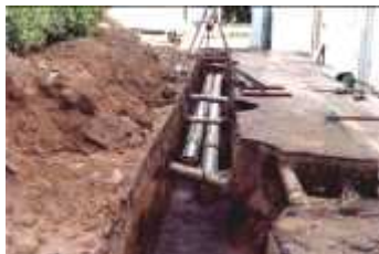
Réseau eau glacée Jean Prince
