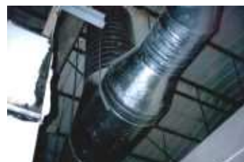
Gaines d'extraction Base Marine
