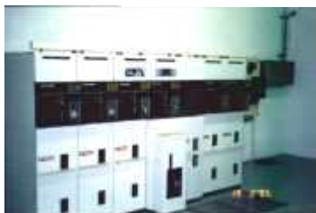
Poste 1 Aéroport de Prague
